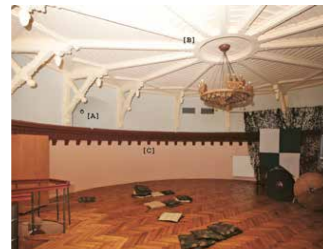
8. att. Piektā stāva bijušās svētku zāles griestu daļa. A – šaujamlūka ar cilpu lielgabala stiprināšanai, B – 1892. gada pārbūvē izveidotie griesti, C – paneļu dzega. Foto: Artūrs Lapiņš, 2013.
